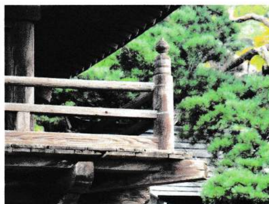
写真-1 4 高欄床板の傷みが進んでいる
