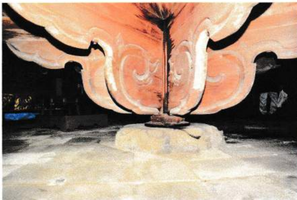
写真-12 転輪蔵に雨漏り
